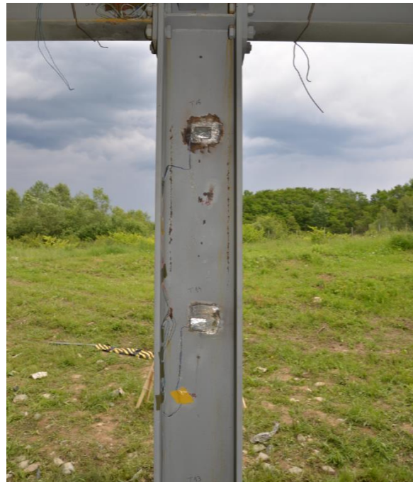
Fig. 7 Vedere cu stâlpul central după testul E3
